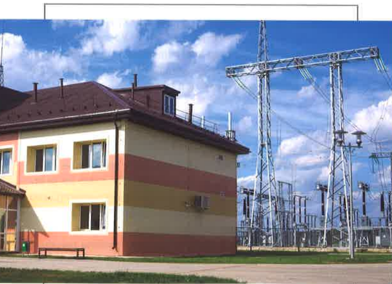
Подстанция 330 кВ «Минск-Северная»
